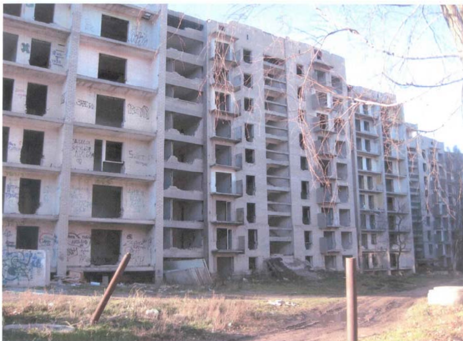
Фото 2. Незавершене будівництво, пов'язане з неврахуванням розвитку небезпечних геологічних процесів. Фото Головкова А. Е. / Photo 2. Unfinished construction, due to the failure to take into account the development of dangerous geological processes. Photo by Golovkov A. E.
