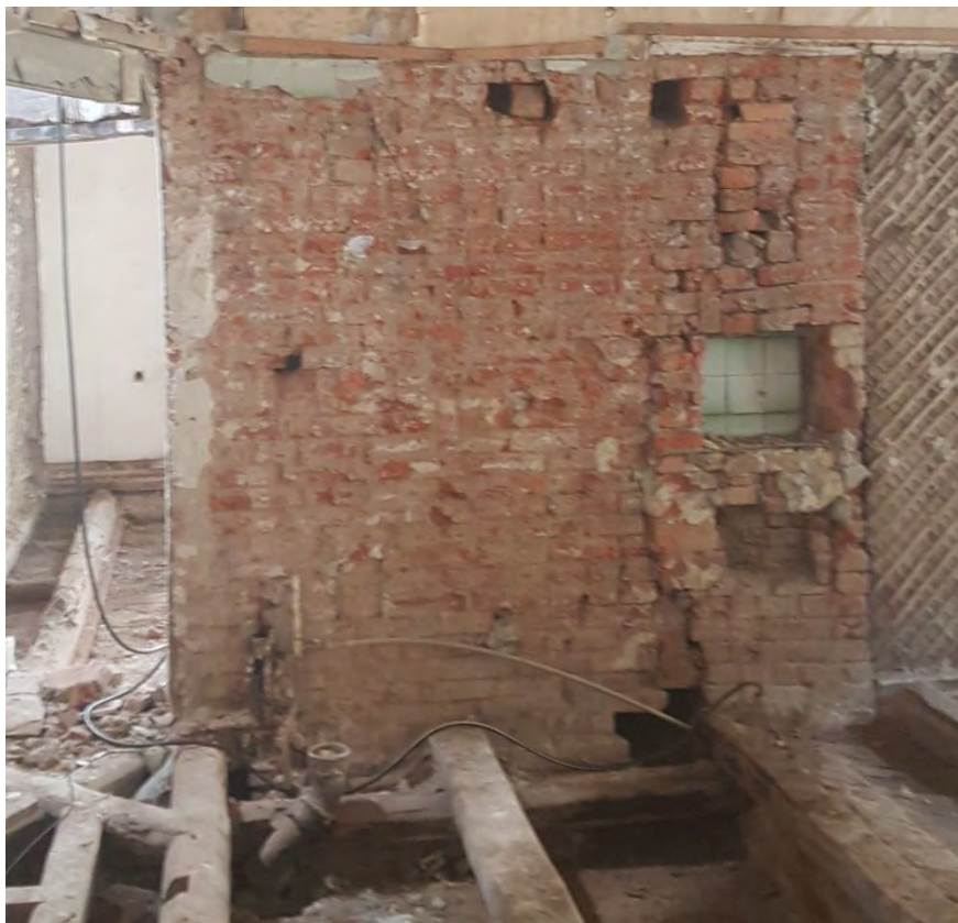
Рис. 13. Пошкодження внутрішньої цегляної стіни на 1-му поверсі. Fig. 13. Inner brick wall damages on the first floor
