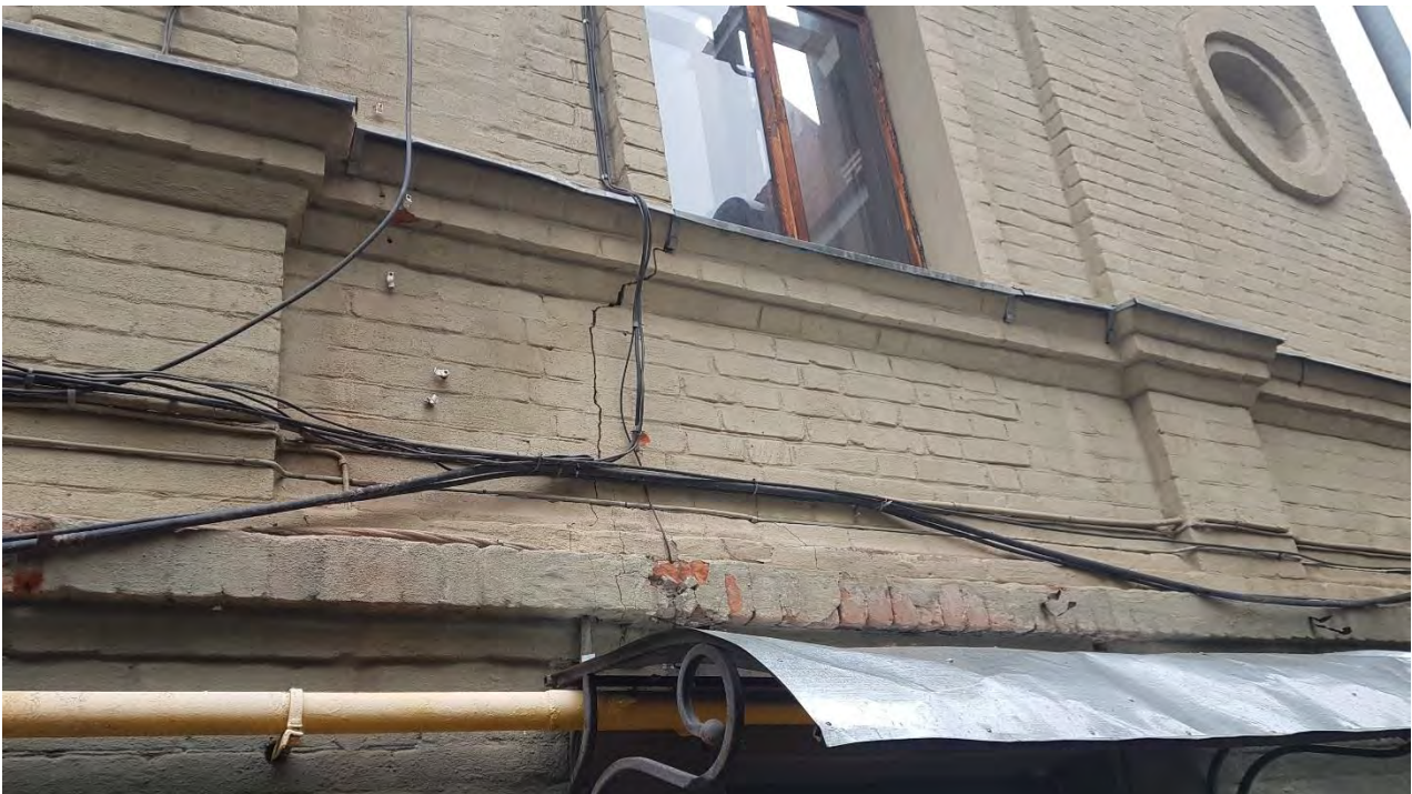
Рис. 11. Тріщини у зовнішніх стінах / Fig. 11. Cracks in outside walls
