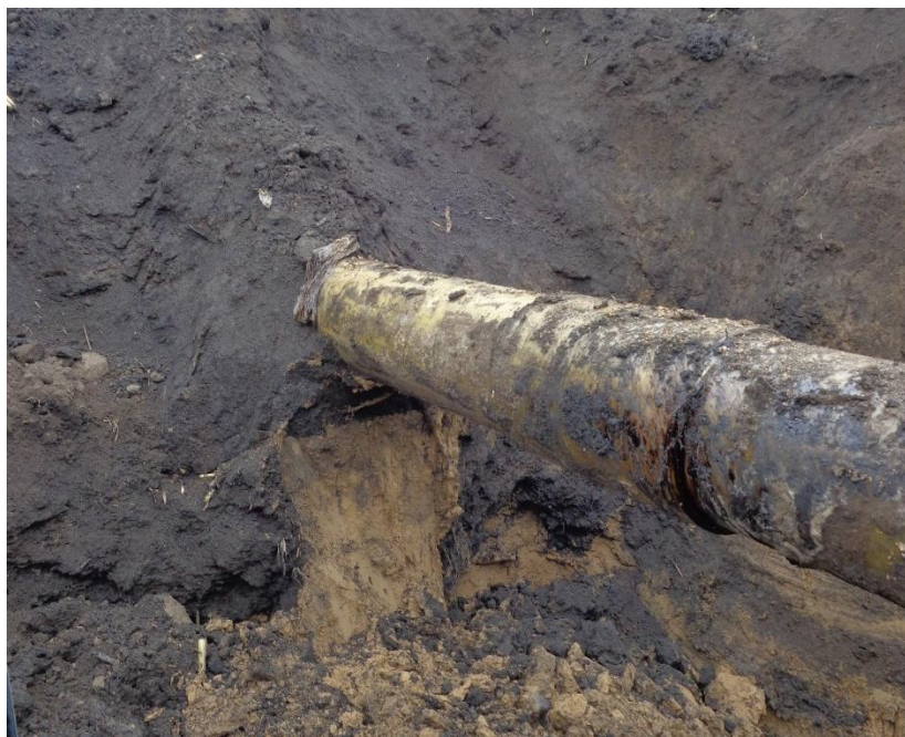
Рис. 1. Розгерметизація стику полімерного трубопроводу на Анастасівському родовищі / Fig. 1. Depressurization of the joint of the polymer pipeline at the Anastasivsk field
