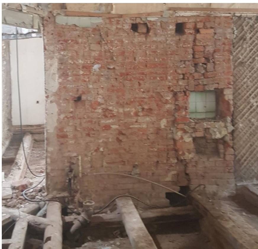
Рис. 13. Пошкодження внутрішньої цегляної стіни на 1-му поверсі. Fig. 13. Inner brick wall damages on the first floor
