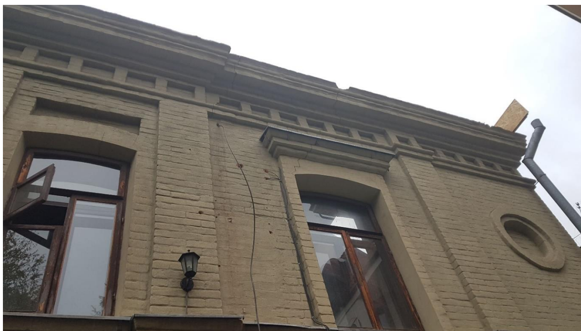
Рис. 12. Тріщини в цегляних арочних перемичках. Fig. 12. Cracks in brick arched bridges
