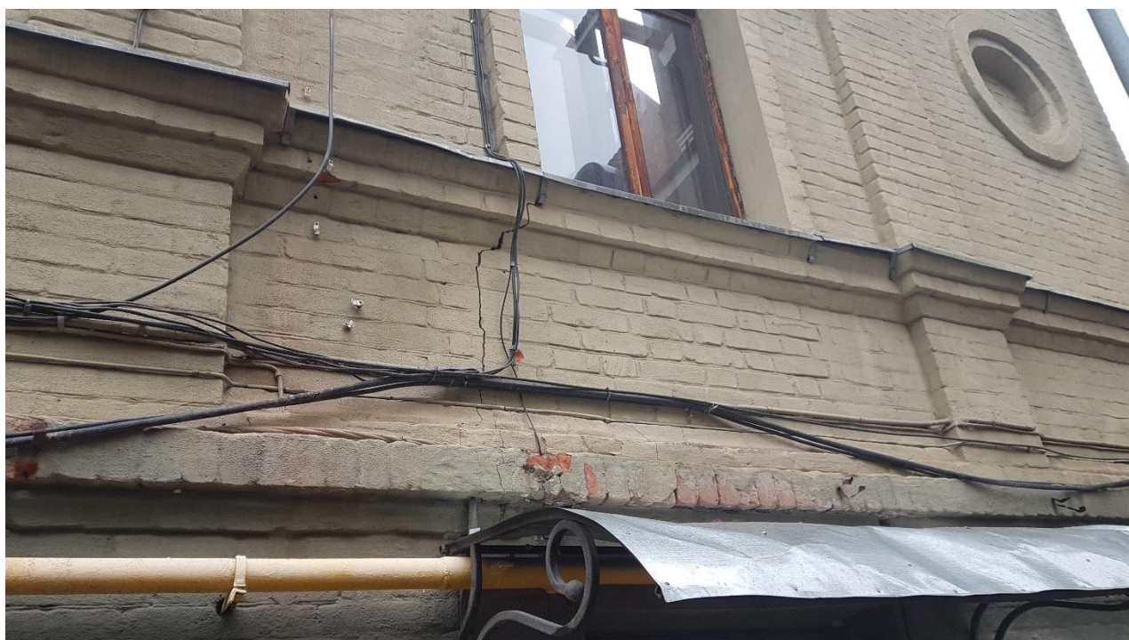
Рис. 11. Тріщини у зовнішніх стінах / Fig. 11. Cracks in outside walls
