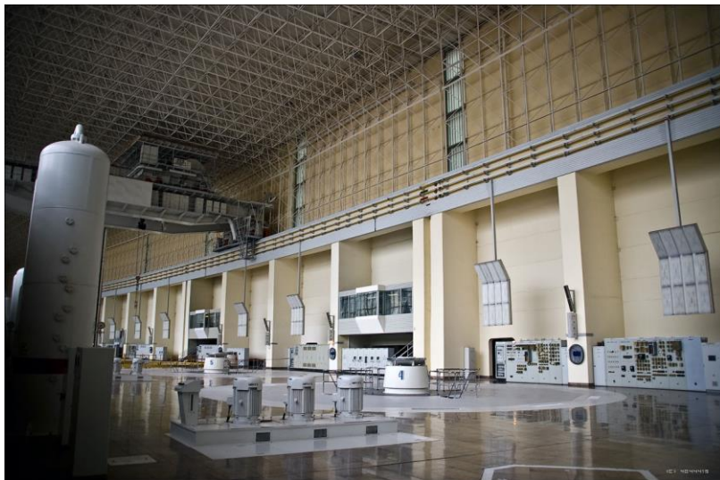
Рис. 1 – Машинный зал СШГЭС до аварии (фото http://bigpicture.ru/?p=4962 )
