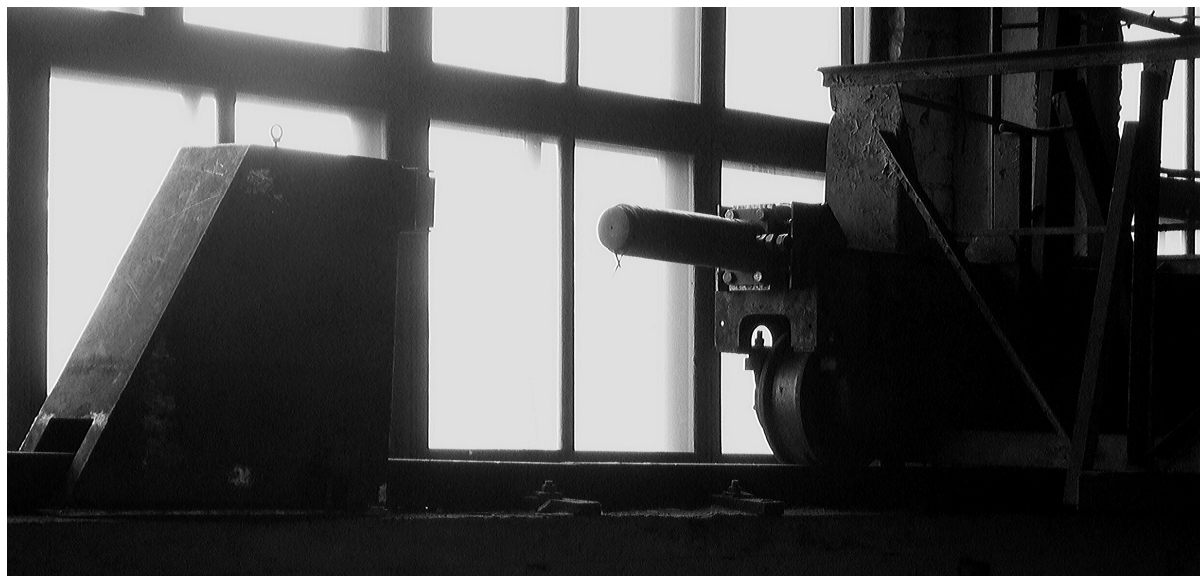
Рис. 6 – Елементи експериментальної захисної системи мостового крана 5т40
