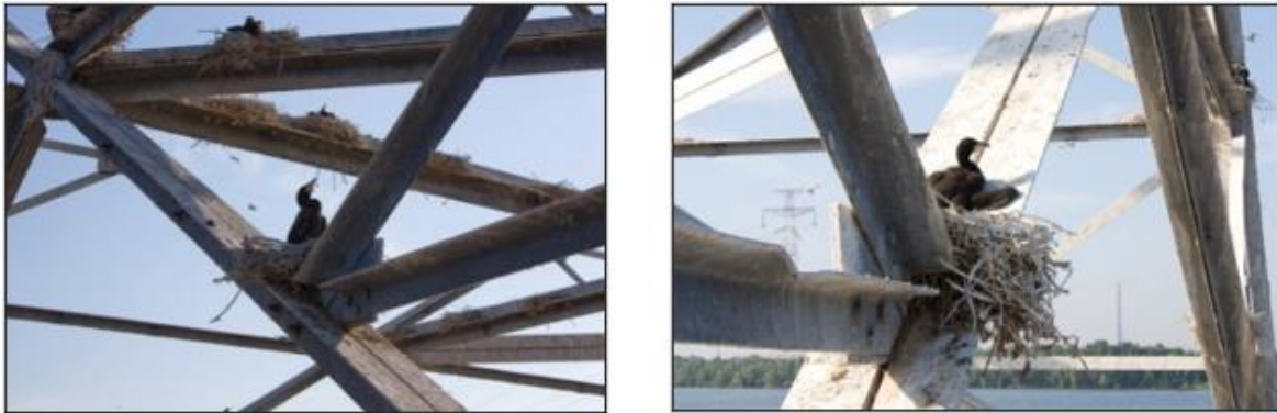
Рис. 6. Особливості розташування гнізд великого баклана на опорах ЛЕП 330 кВ у 2012 р. Фото Горлова П.І. Fig. 6. Nesting features of the Great Cormorant on 330 kV power line towers in 2012. Photo by Horlov P.I.
